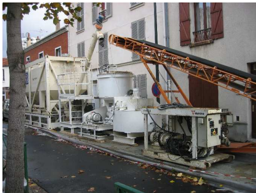
Centrale de traitement et stockage rue Ernest Renan
