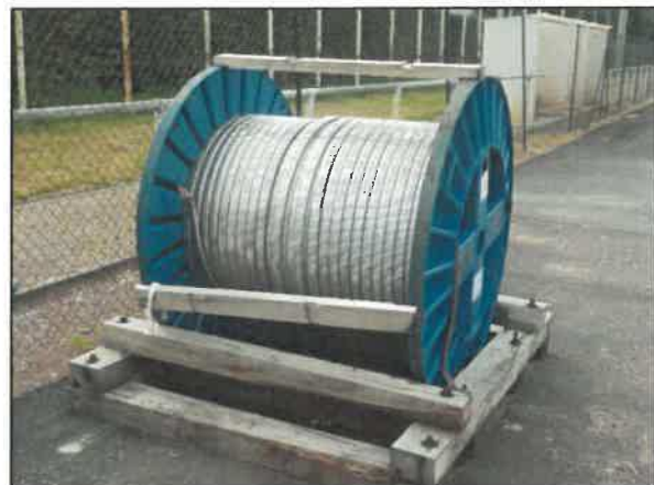
Figure 65 – Photo du câble d'alimentation de la pompe
