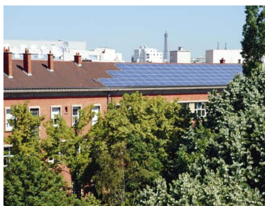
Les panneaux solaires posés sur l'école Jean-Jaurès.
