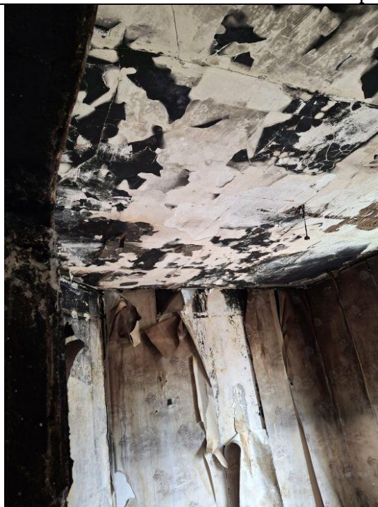
Photo 14 : RdC : Plafond instable
