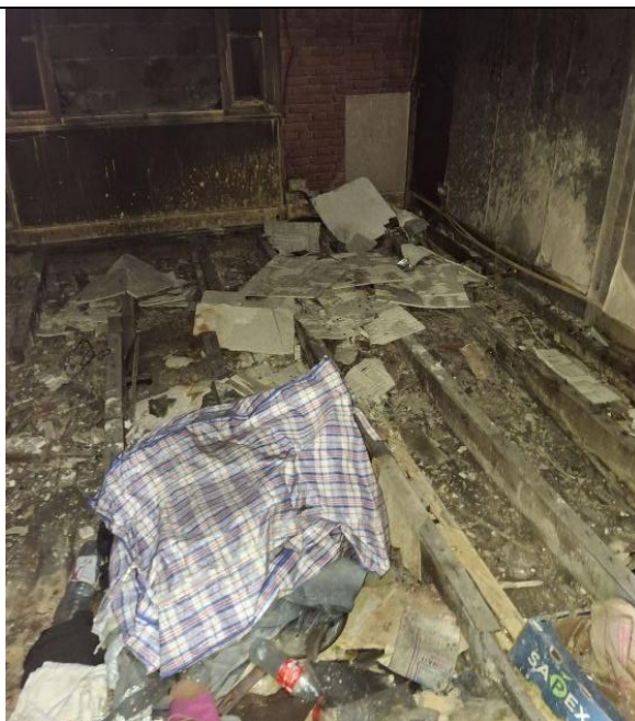
Photo 13 : RDC surélevé : Effondrement du plancher
