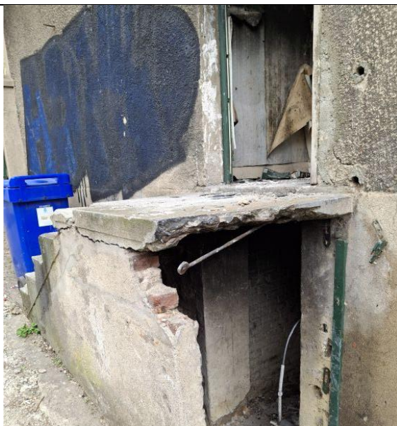
Photo 9 : Dalle du palier de l'entrée instable
