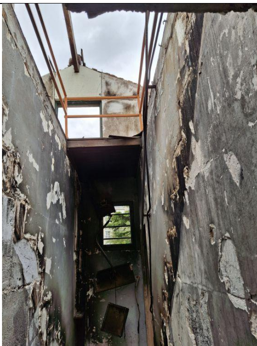
Photo 15 : Couloir : Toiture manquante t murs instables
