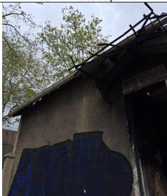
Photo 8 : Rebord de toiture calciné
