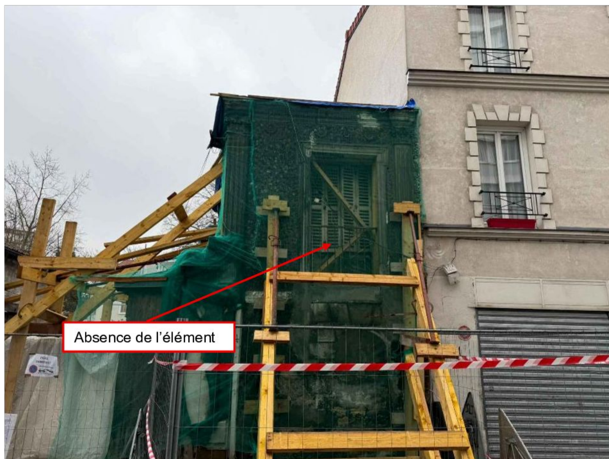
Étalement de la façade côté cours juste avant notre première intervention
