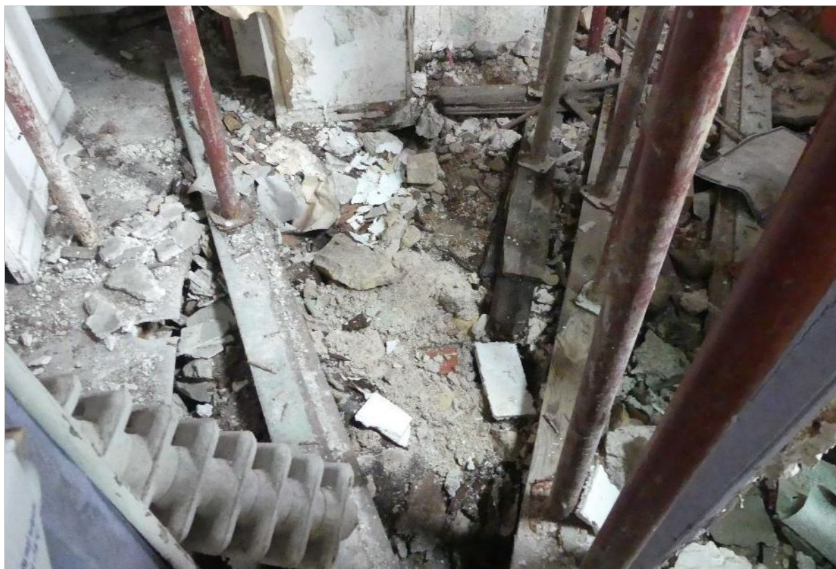
Visualisation du plancher bas du RDC détruit depuis le RDC
