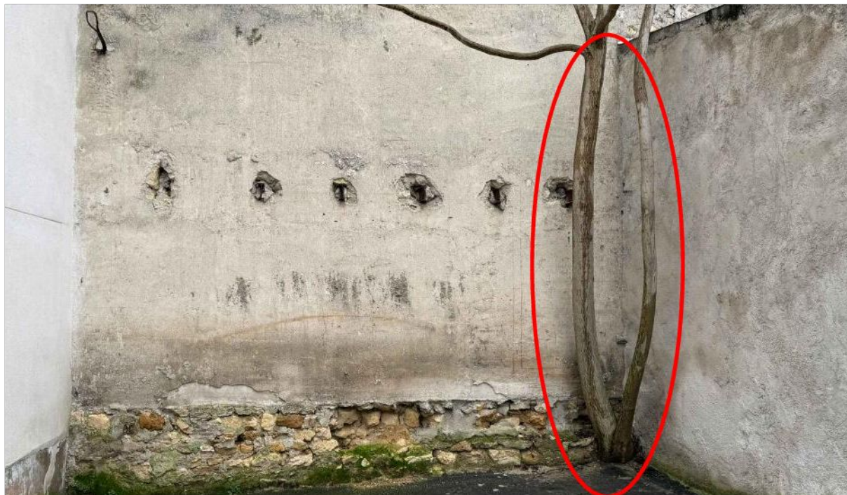
Visualisation du désordre D5 durant notre première intervention
