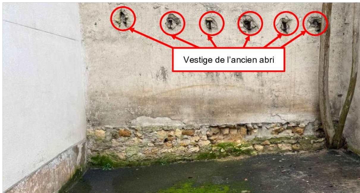
Visualisation du désordre D3 durant notre première intervention
