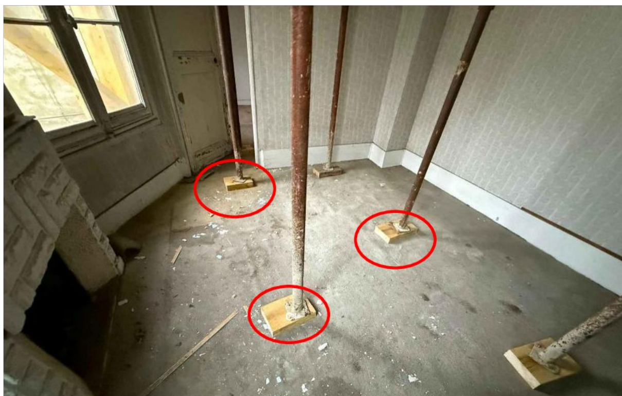
Visualisation du désordre D4 durant notre première intervention
