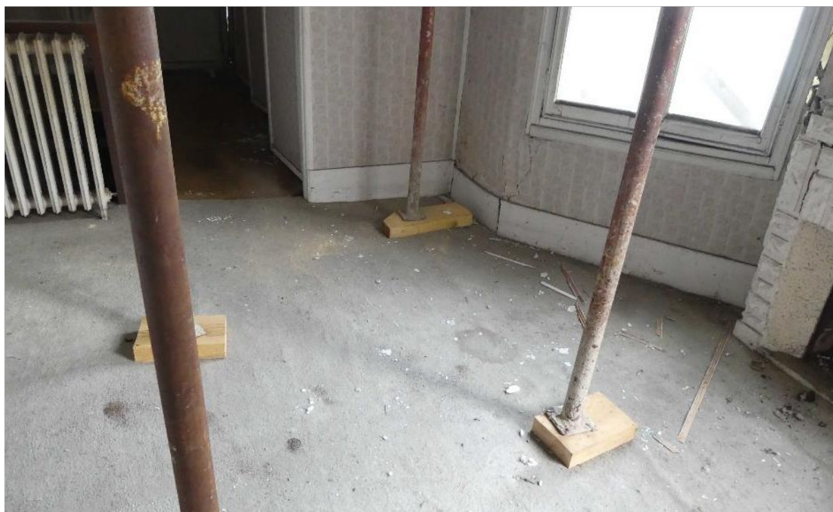
Visualisation du désordre D4 durant notre seconde intervention : Absence de traitement
