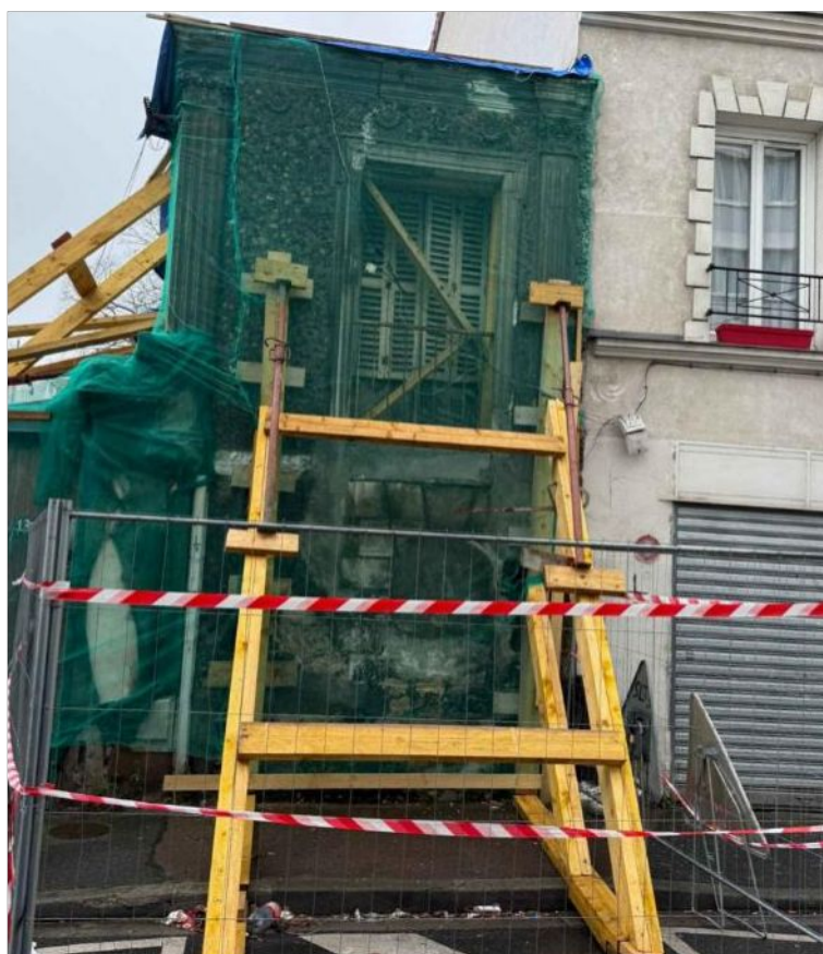
Étalement de la façade côté rue juste avant notre première intervention
