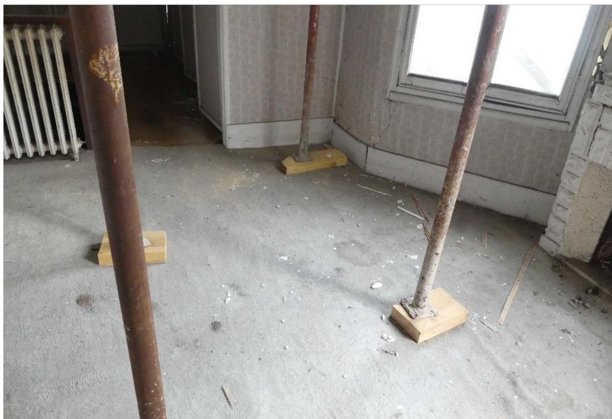
Visualisation du désordre D4 durant notre seconde intervention : Absence de traitement
