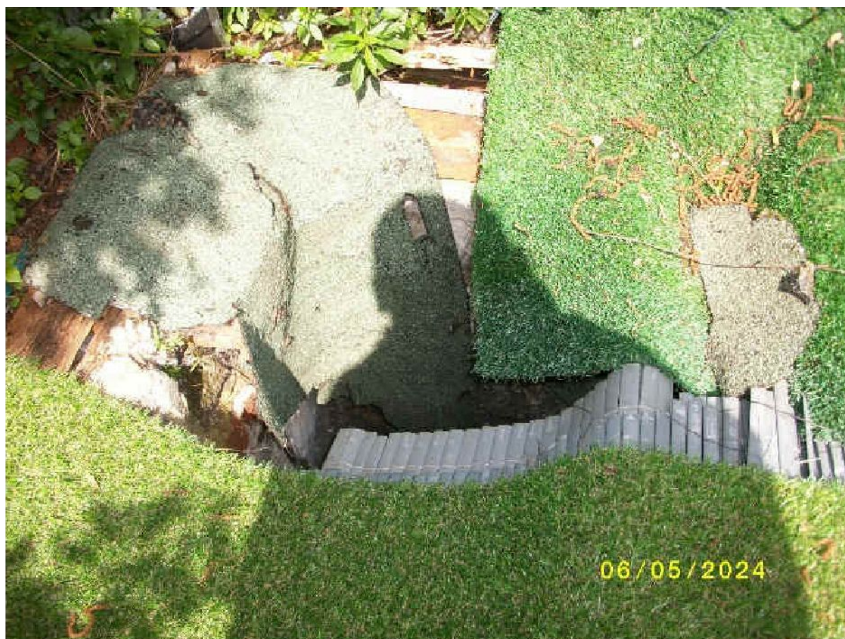
Trappe d'accès au compteur gaz
