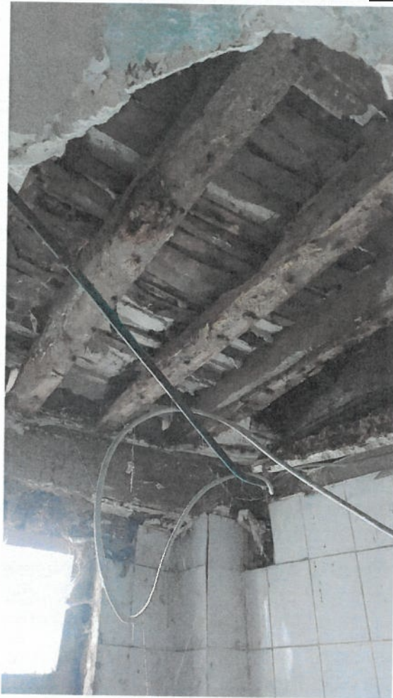
Photo 9: Dégradation avancée de plafonds au niveau du Rez-de-chaussée
