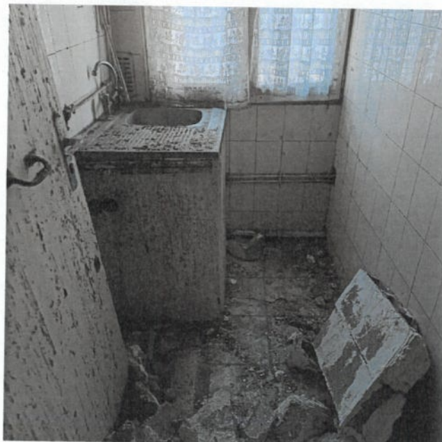
Photo10 : Humidité généralisée, déjections animales et infiltrations massives sont constatées sur l'ensemble des cloisons intérieures
