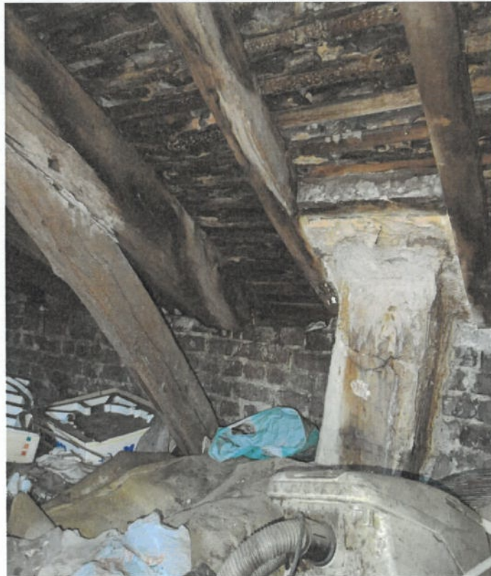
Photo 4 : Dégradation avancée de la charpente principale du bâtiment A Déformation importante de la structure porteuse-Risque certain d'effondrement partiel ou total à court terme
