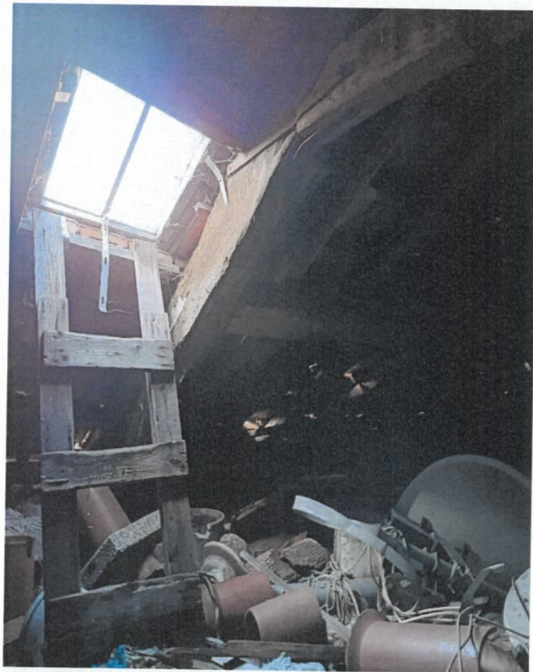
Photo 5 : Dégradation avancée de la charpente principale du bâtiment A Déformation importante de la structure porteuse au niveau des arbalétriers -Risque d'effondrement partiel ou total à court terme
