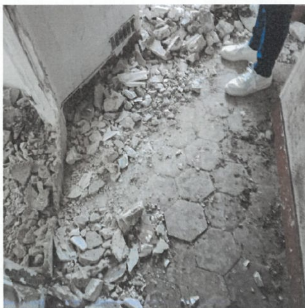
Photo 8 : Détérioration avancée des planchers constatée à chaque niveau du bâtiment
