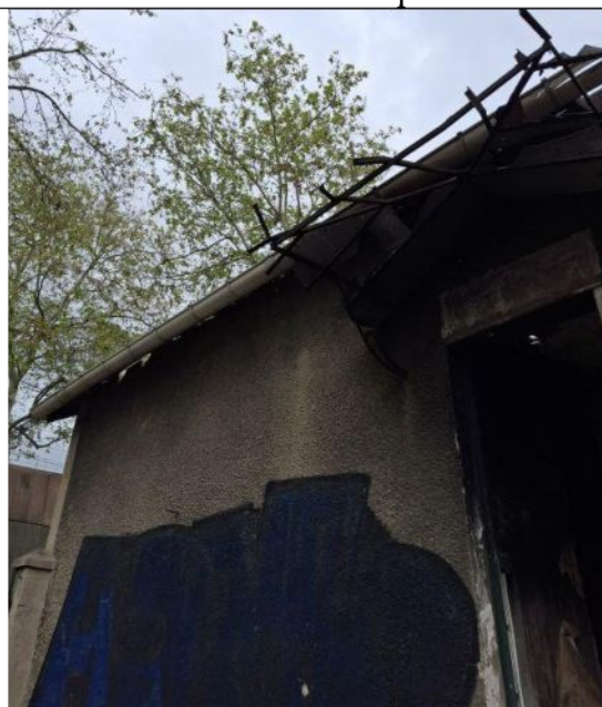
Photo 8 : Rebord de toiture calciné
