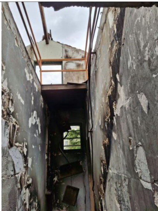
Photo 15 : Couloir : Toiture manquante et murs instables
