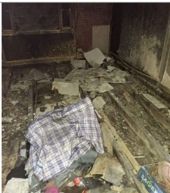
Photo 13 : RDC surélevé : Effondrement du plancher
