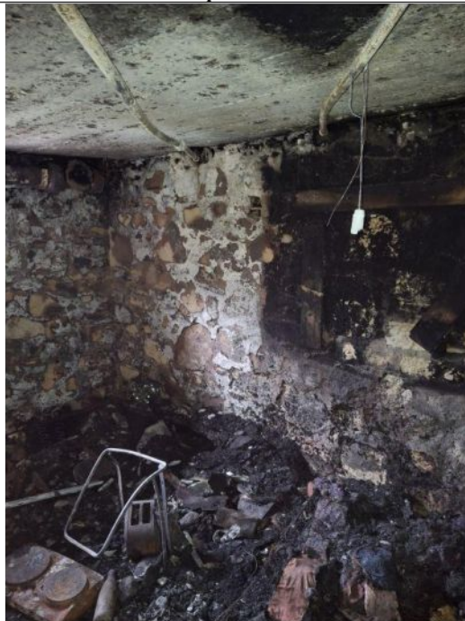
Photo 10 : Pièce cuisine au sous-sol : probable départ de feu : fragilisation de la dalle de plafond
