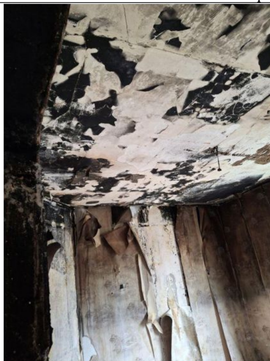
Photo 14 : RdC : Plafond instable
