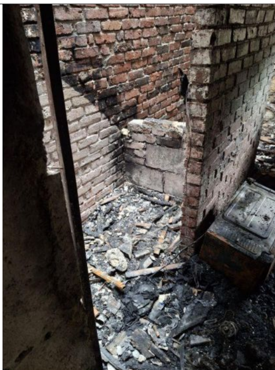
Photo 11 : Pièce au sous-sol : fragilisation des murs en pierre
