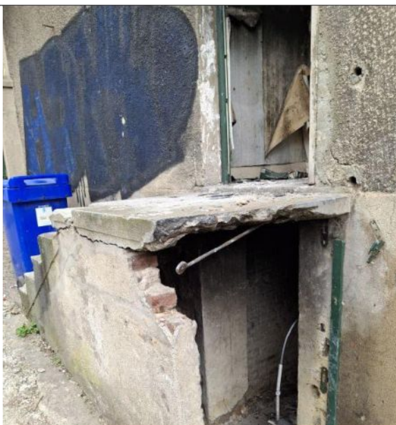
Photo 9 : Dalle du palier de l'entrée instable
