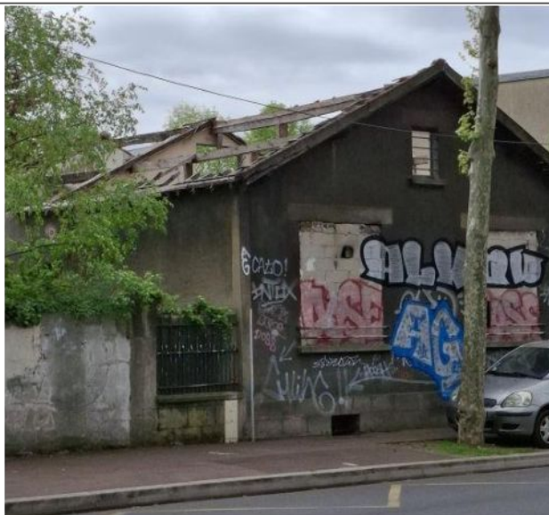
Photo 1 : Pignon sur rue ; toiture manquante
