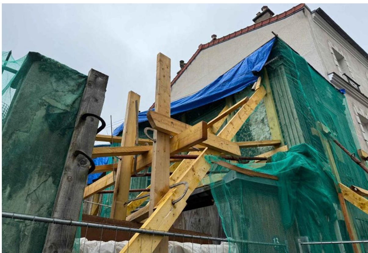
Étalement de la façade côté cours juste avant notre première intervention
