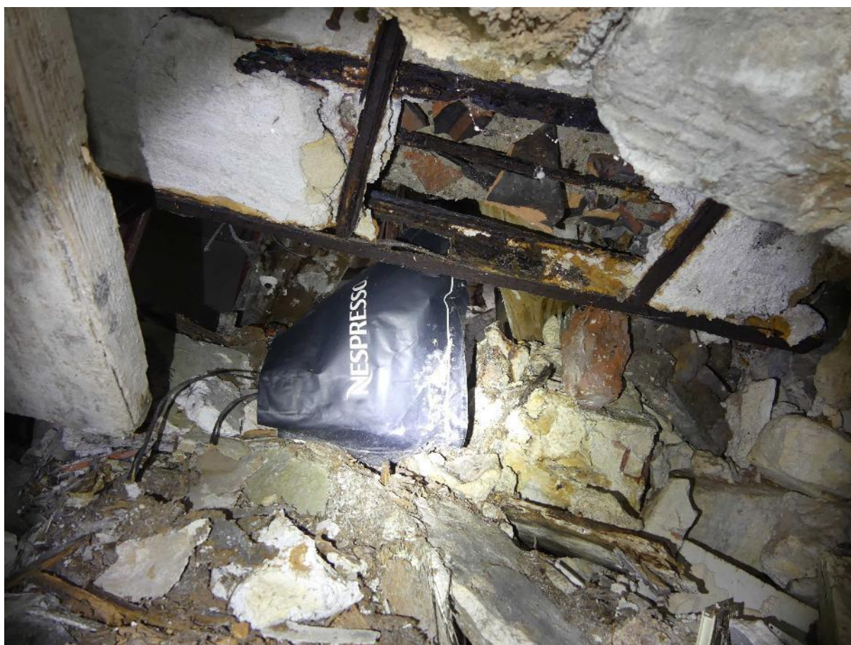
Visualisation du plancher bas du RDC détruit depuis la cave
