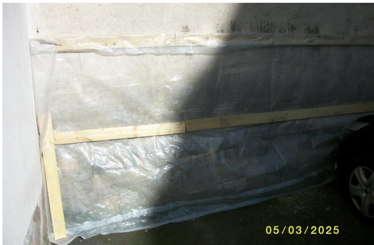
Visualisation du traitement du désordre D3 après notre première intervention
