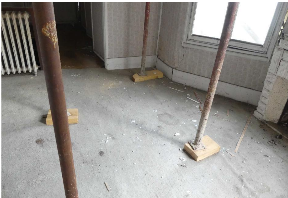
Visualisation du désordre D4 durant notre seconde intervention : Absence de traitement
