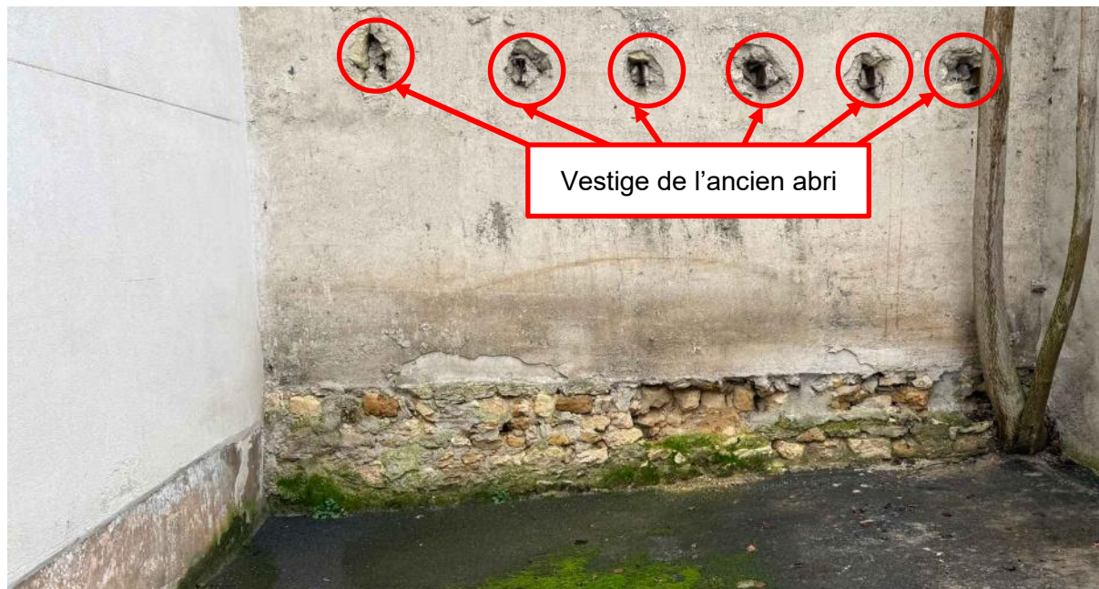
Visualisation du désordre D3 durant notre première intervention
